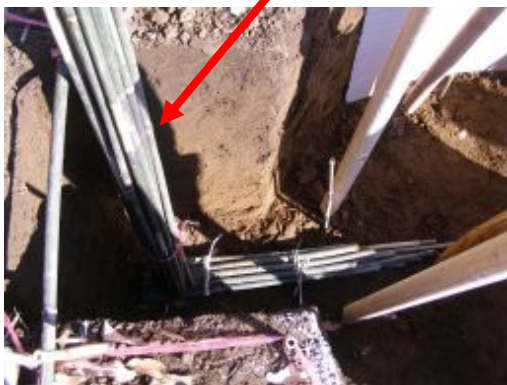
排煙部、煙道部に篠竹の束を設置
