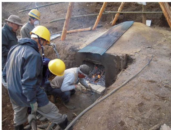
煙突の出口が 80℃～90℃で窯口を絞る
